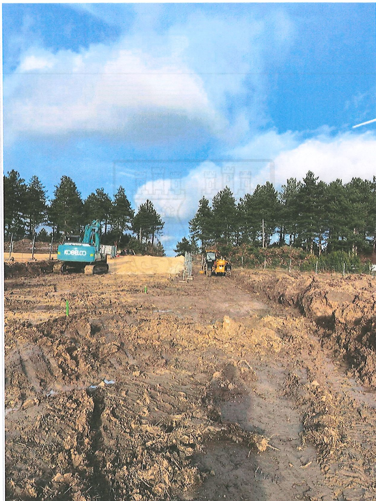
Imagen 13 (ensanchamiento y maquinaria pesada trabajando camino Matarredos límite Comunidad Foral de Navarra)
