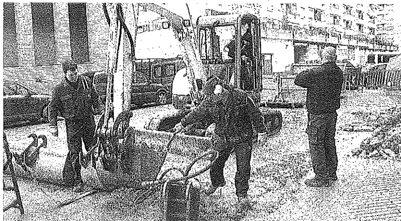
Operarios municipales trabajan en la zona afectada en Beatos Mena y Navarrete. :: MIGUEL HERREROS
