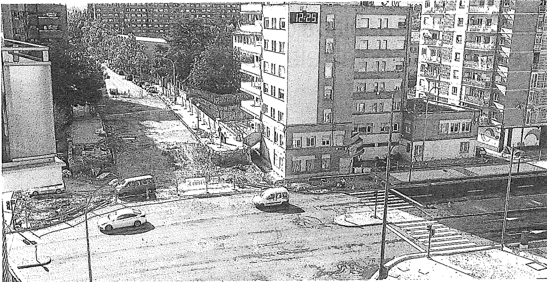
Las actuaciones en torno a la vía férrea precisan de la autorización expresa de ADIF. JUAN MARÍN
